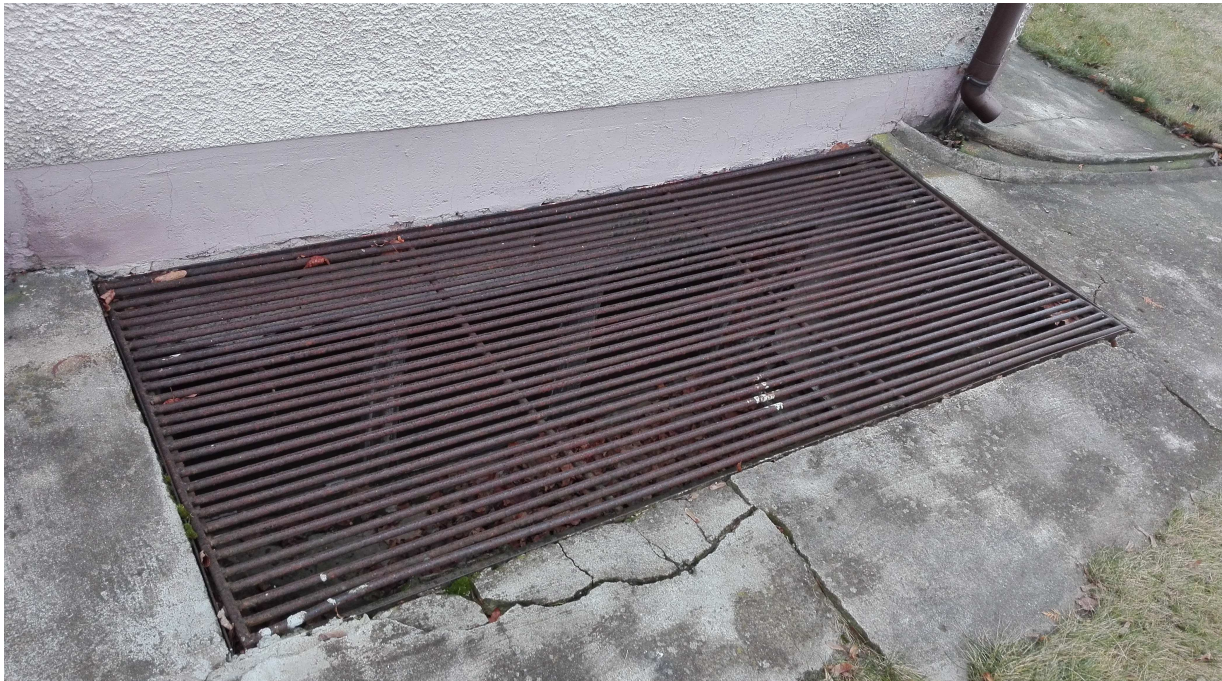
Rys nr 5. Uszkodzona krata do szachtu piwnicznego, uszkodzona opaska wokół budynku.
