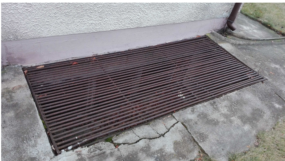
Rys nr 5. Uszkodzona krata do szachtu piwnicznego, uszkodzona opaska wokół budynku.
