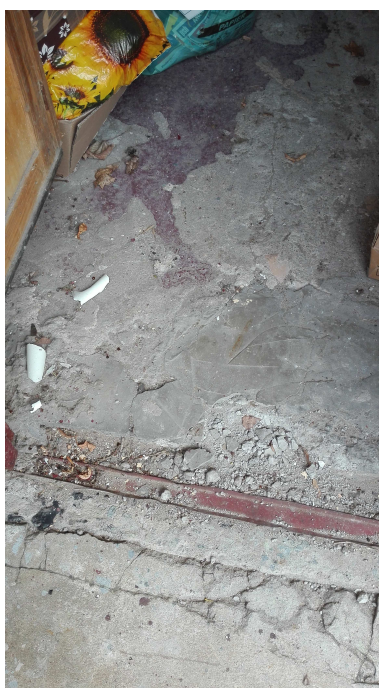
Rys nr 8. Uszkodzenia posadzki betonowej.
