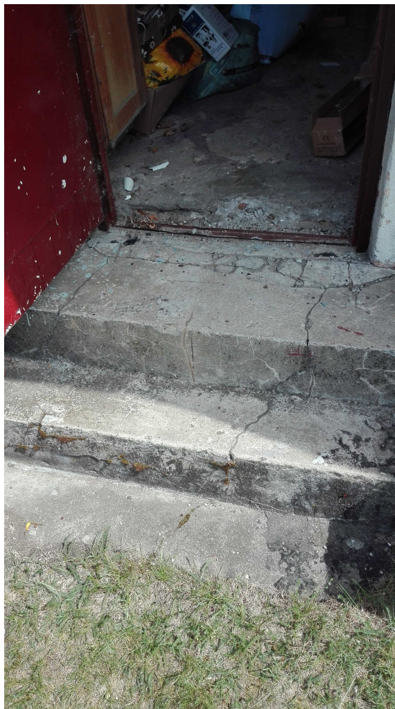
Rys nr 5. Uszkodzenia schodów wejściowych do budynku.
