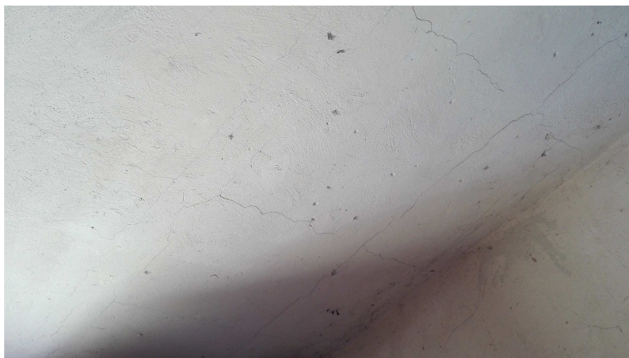
Rys nr 6. Spękanie tynków wewnętrznych w budynku.
